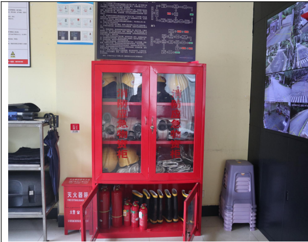
生产区前门岗哨间消防应急物资柜
