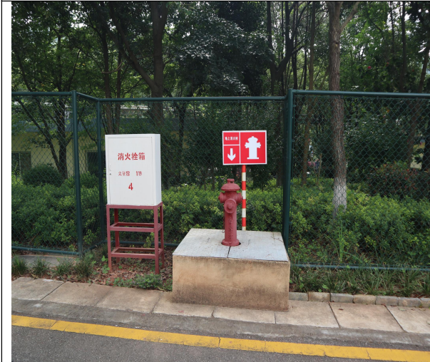
生产区消防栓及消防箱
