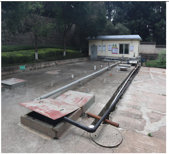
污水处理站及中水池
