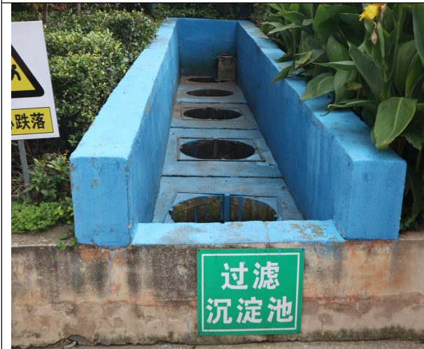
污水处理站前过滤沉淀池
