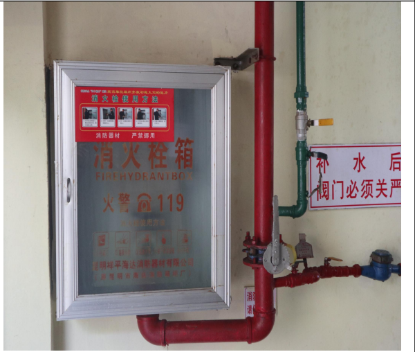
生产车间内室内消防栓
