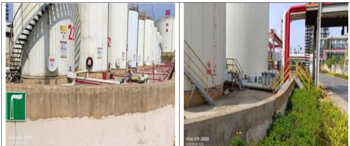
储罐区（围堰+压力表+防爆装置+泄气阀）
