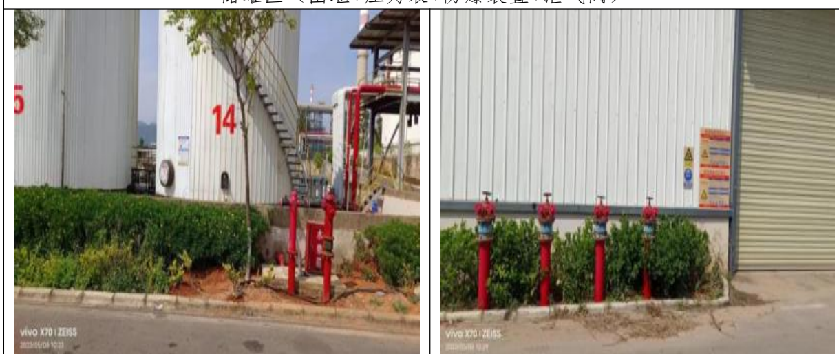
储罐区、仓库区消火栓配置情况
