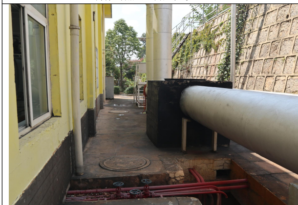
锅炉废气治理设施
