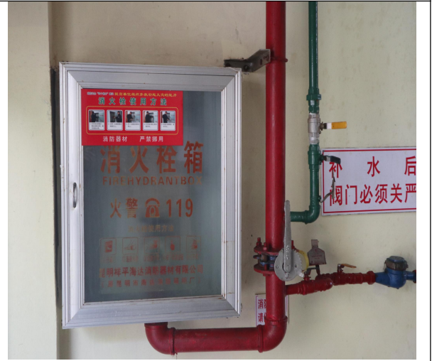
生产车间内室内消防栓
