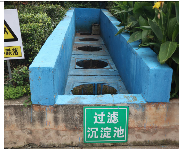
污水处理站前过滤沉淀池
