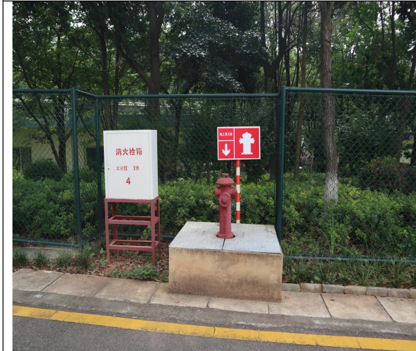
生产区消防栓及消防箱
