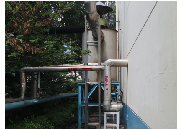
油相废气治理设施 1
