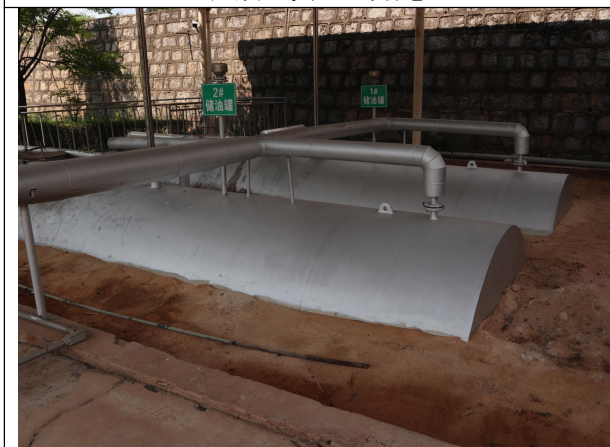
锅炉燃油储罐沙池
