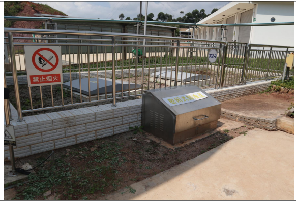
加油站柴油储罐沙池
