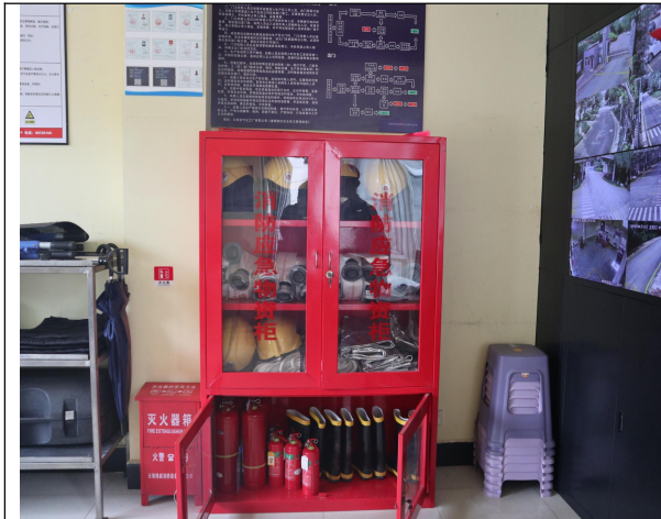
生产区前门岗哨间消防应急物资柜
