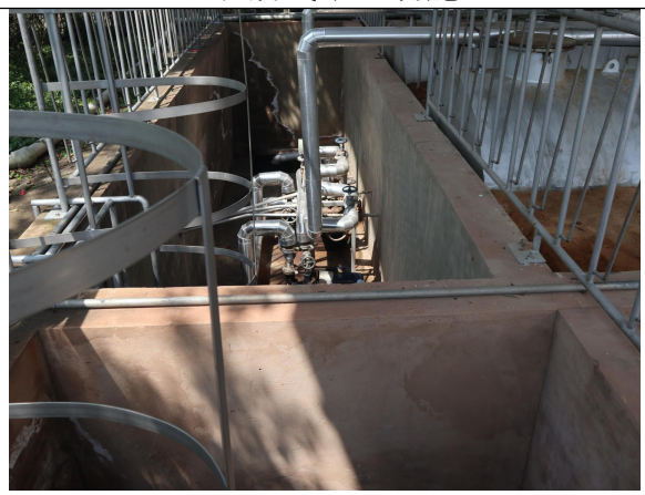
锅炉燃油储罐应急池
