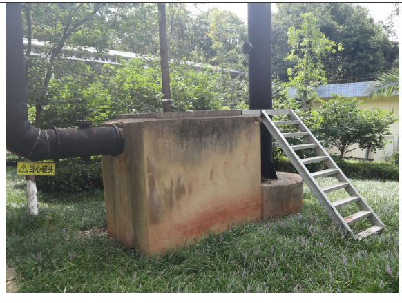
油相废气治理设施 2
