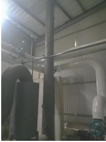
天然气排气筒
