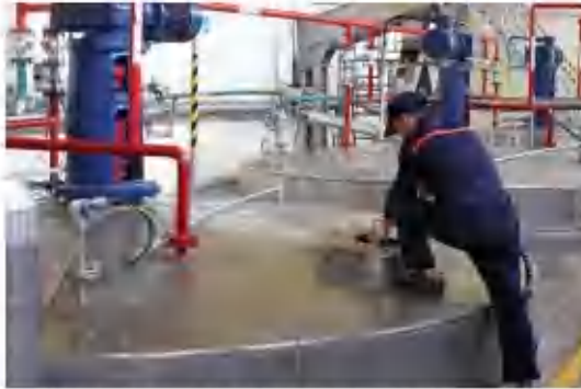
水相操作人员前往三号罐观察水相液位
