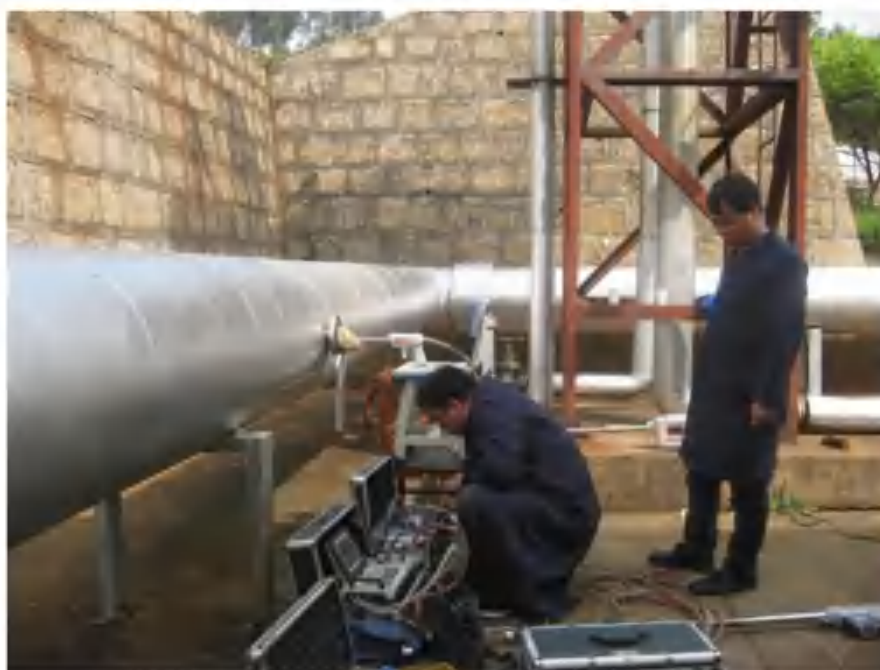
图 13：燃油锅炉烟气排放监测现场照片
