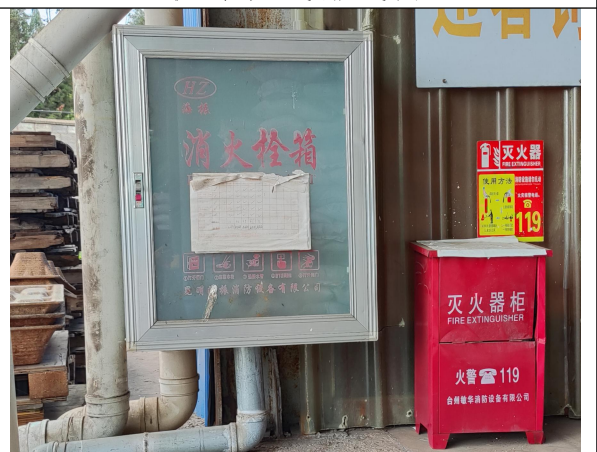
车间消防栓、灭火器
