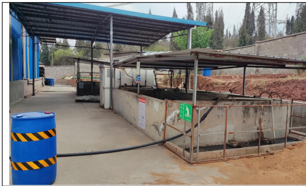
污水处理设施废水收集池
